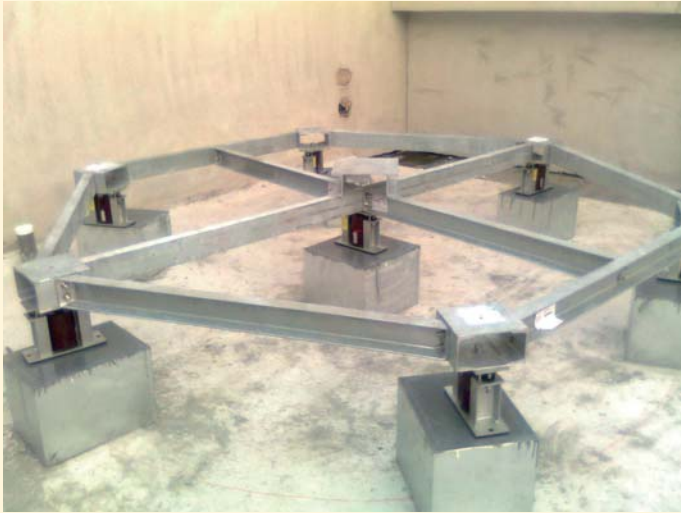
圓形水塔基座搭配 JS
